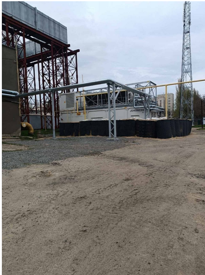
Рисунок 4.2 – Зовнішній вигляд встановленої когенераційної установки Jenbacher JMC 620 GS-N.L (3,3 МВт, вул. Героїв оборони Одеси, 80-В)
