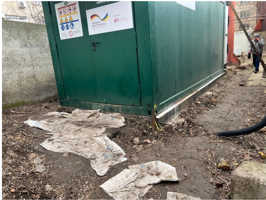
Рисунок 4.3 – Зовнішній вигляд встановленої когенераційної установки 2G G6720 (0,180 МВт, вул. Ріхтера, 148-Б)
