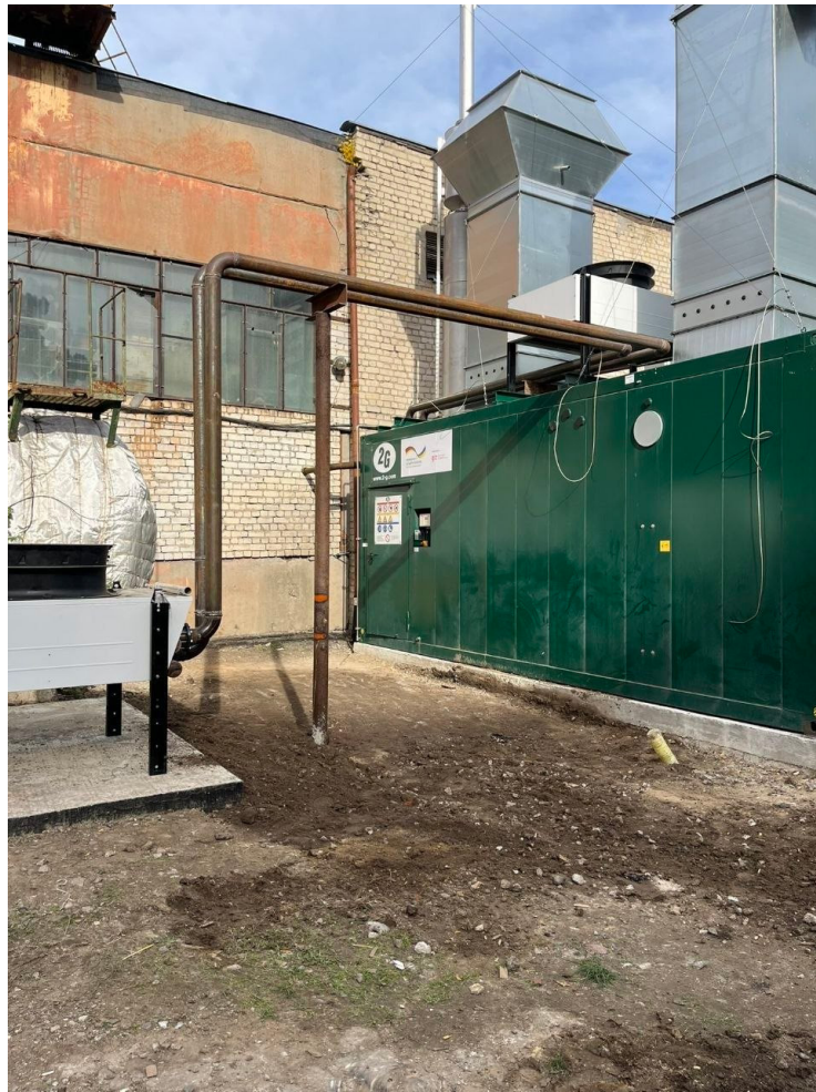
Рисунок 4.5 – Зовнішній вигляд встановленої когенераційної установки 2G G6737 (0,400 МВт, вул. Артура Савельєва, 13-Б)
