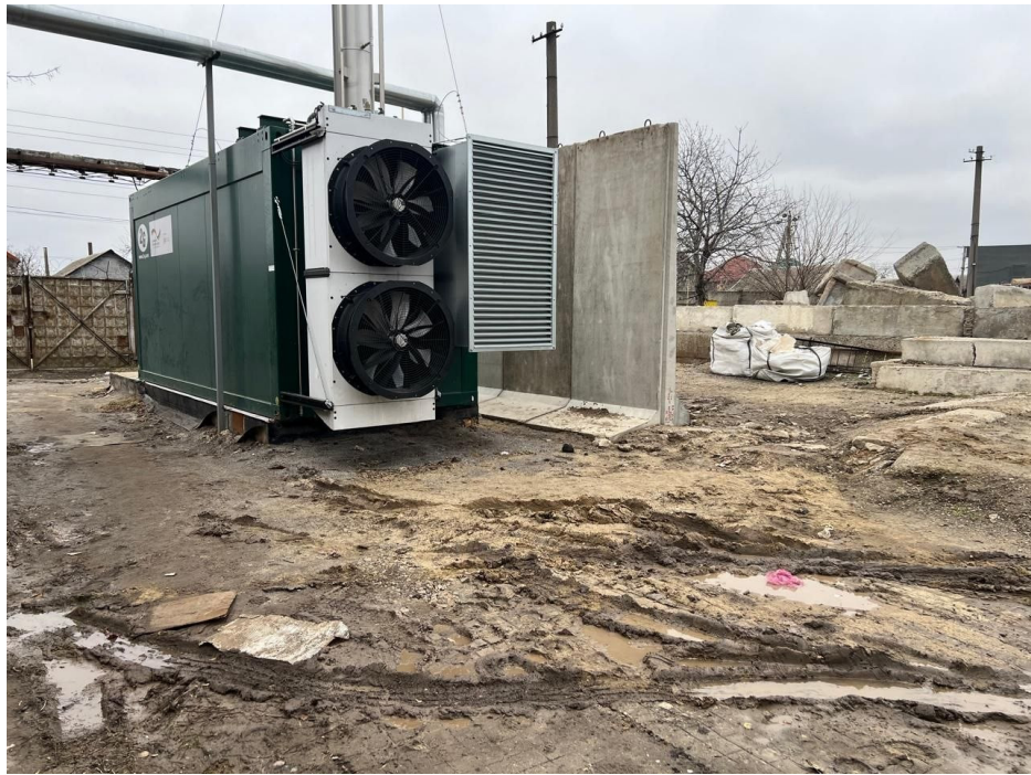
Рисунок 4.4 – Зовнішній вигляд встановленої когенераційної установки 2G G6720 (0,180 МВт, вул. Клинова, 2)
